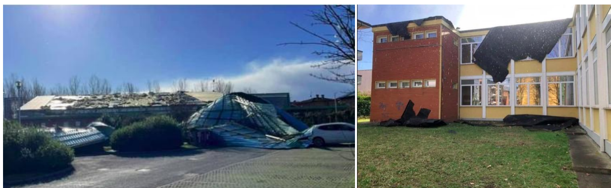
Figura 19: Danni nel Bolognese. Copertura della piscina a Ozzano divelta, a sinistra, tetto danneggiato in una scuola a Pianoro, a destra (fonte Il Resto del Carlino).
