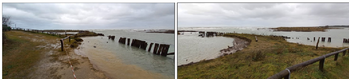
Figura 27: Erosione e danneggiamento opera di difesa in legno nel Ravennate presso la Foce del Bevano (RA).
