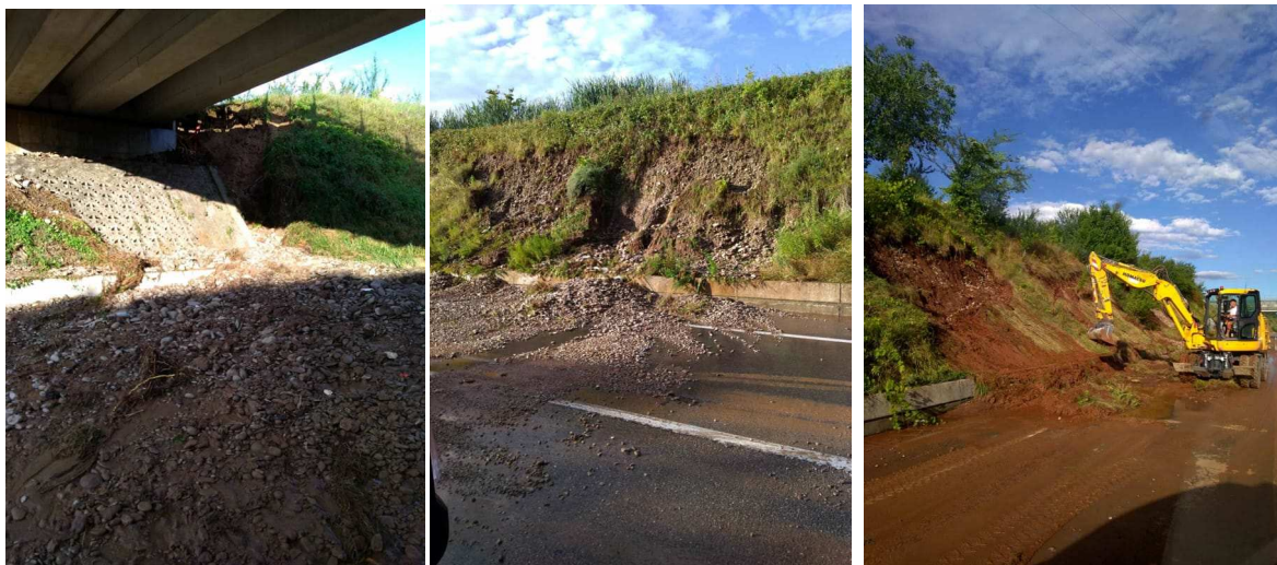
Figura 19: Frana a Vignola lungo la Pedemontana. Fonte Modenatoday.
