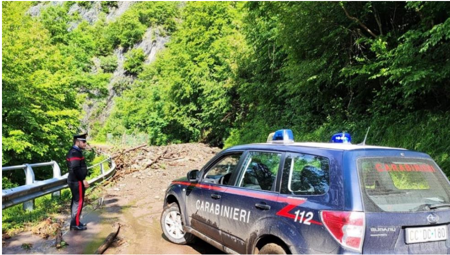
Figura 25: Particolare di una delle due interruzioni stradali di Fig. 24 (foto Bologna Today).
