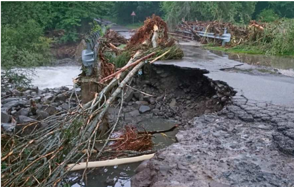
Figura 40: Cedimento della spalla del ponte lungo via Rotari, torrente Tagliole (confine tra Comuni di Pievepelago e Fiumalbo, MO) (foto su Facebook).
