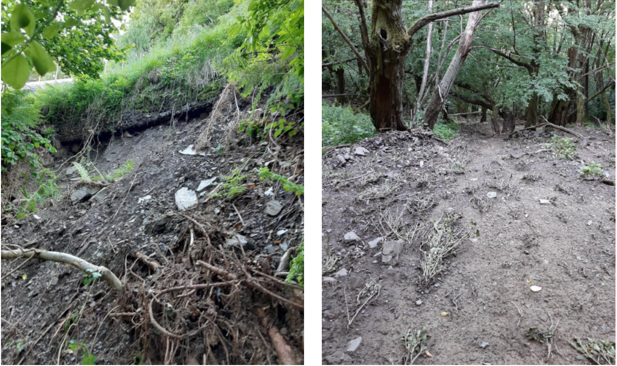
Figura 27: A sinistra: sottoescavazione della gabbionata di protezione della scarpata di valle della SP55 "Case Forlai" in loc. Sambucedro (Alto Reno Terme, BO), (foto Università di Bologna). A destra: dilavamento del suolo leggermente a valle rispetto alla immagine a destra.
