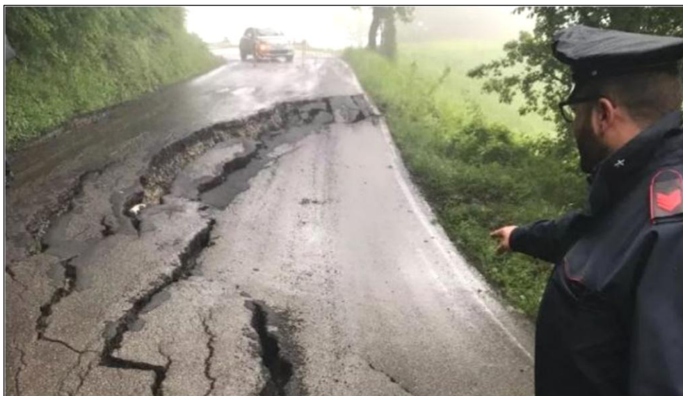
Figura 47: Cedimento stradale sulla SP 54 nei pressi della località Cerdolo dei Coppi (foto Gazzetta di Reggio)
