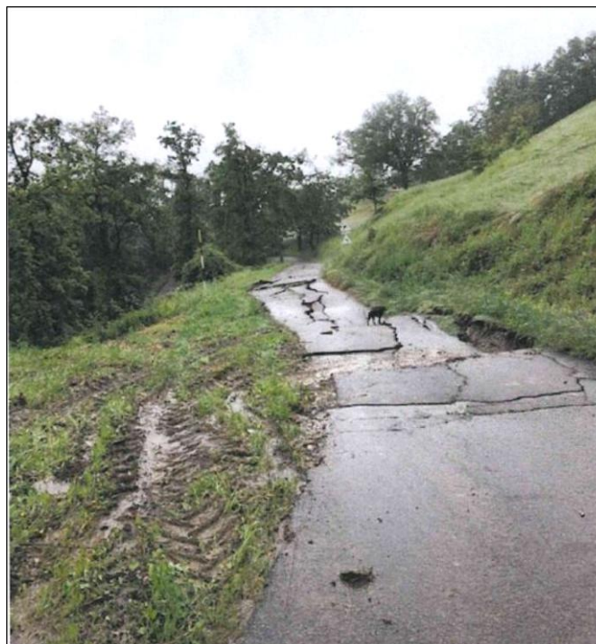
Figura 59:: Tratto stradale di via Cassuolo interessato dal dissesto (foto Comune Prignano sulla Secchia).
