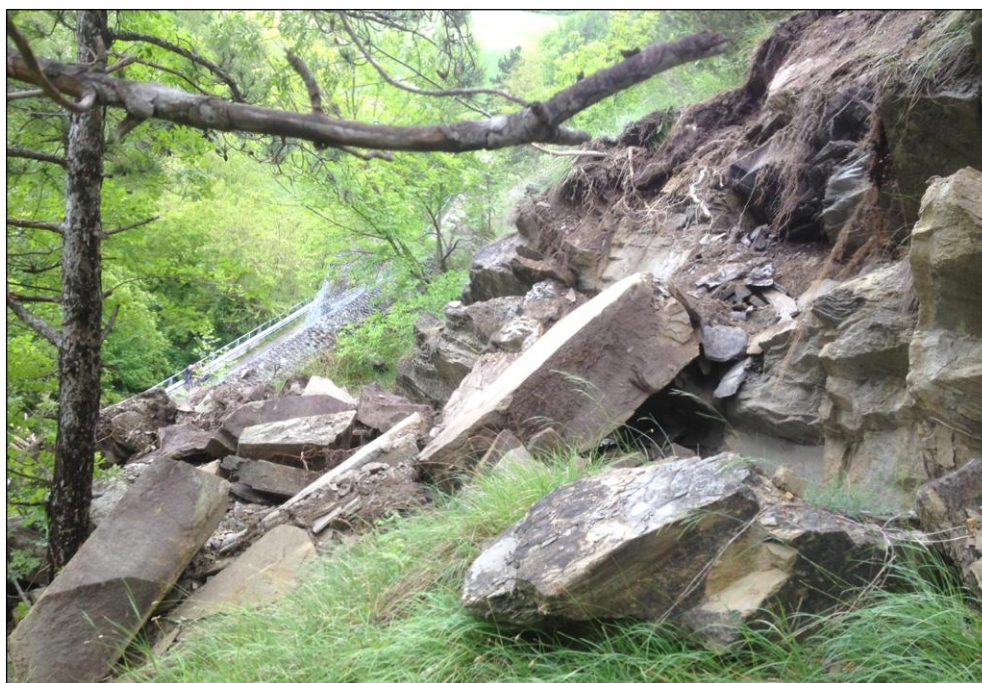
Figura 45: Crollo avvenuto sulla Strada Provinciale 306R "Casolana Rioliese" in località Mercatale (foto Provincia di Ravenna).
