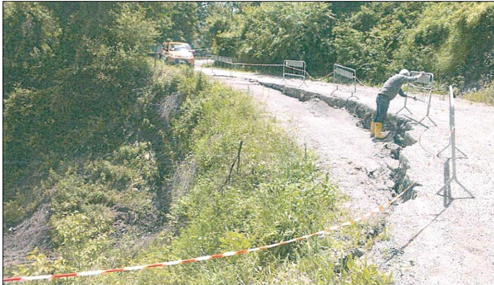
Figura 46: Cedimento del terreno sottostradale in via Bucciardi a San Cassiano (foto Comune Baiso)
