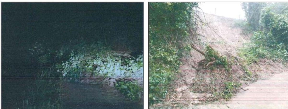
Figura 41: Dissesti che hanno interessato la SC Montesorbo – Cà di Pisino (foto Comune Mercato Saraceno).
