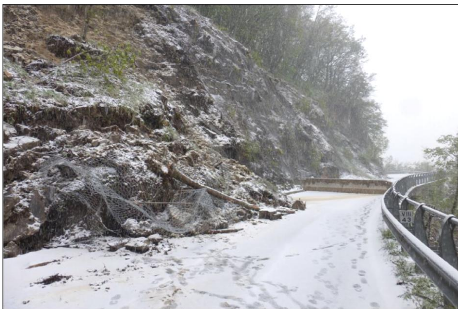
Figura 42: Interruzione sulla SP 324 “del Passo delle Radici” (foto Provincia di Modena).
