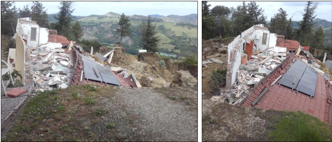
Figura 50: Dettaglio dell'abitazione distrutta dalla frana (foto SGSS e Servizio Area Reno, ARSTePC).
