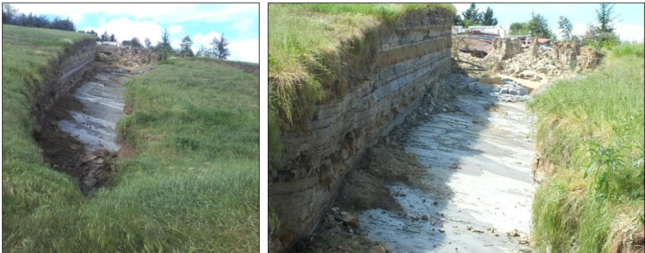
Figura 49: Scarpata di distacco e dettaglio del piano di scivolamento della frana (foto SGSS e Servizio Area Reno, ARSTePC).
