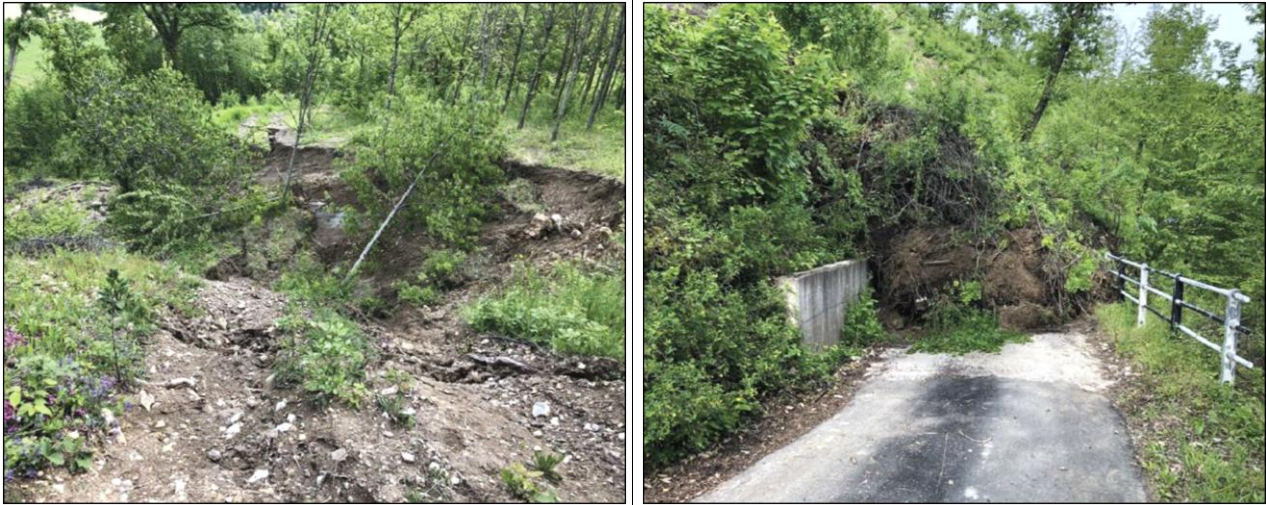
Figura 40: Frana in località Brana di Montorio; area sorgente (sinistra) e accumulo sulla sede stradale (destra) (foto Comune Monzuno).
