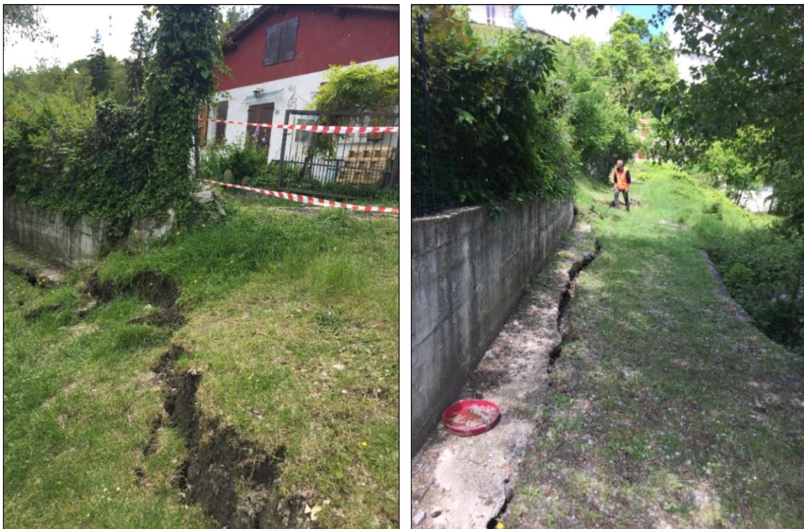
Figura 54: Danni causati dalla frana in località Suviana Tramonti (foto Consorzio della Bonifica Renana).
