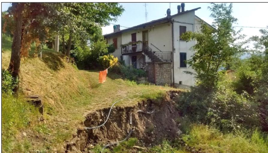
Figura 43: La frana di Giuncheto di Saltino nei pressi di uno degli edifici (foto Comune Prignano sulla Secchia).
