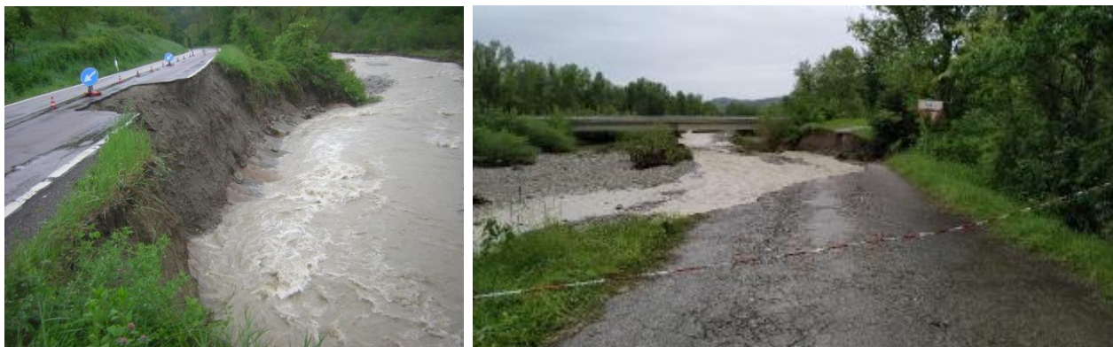
Figura 20: Erosione spondale del Samoggia sulla SP27 e in via Bernardi a Monte S. Pietro del 13 maggio
