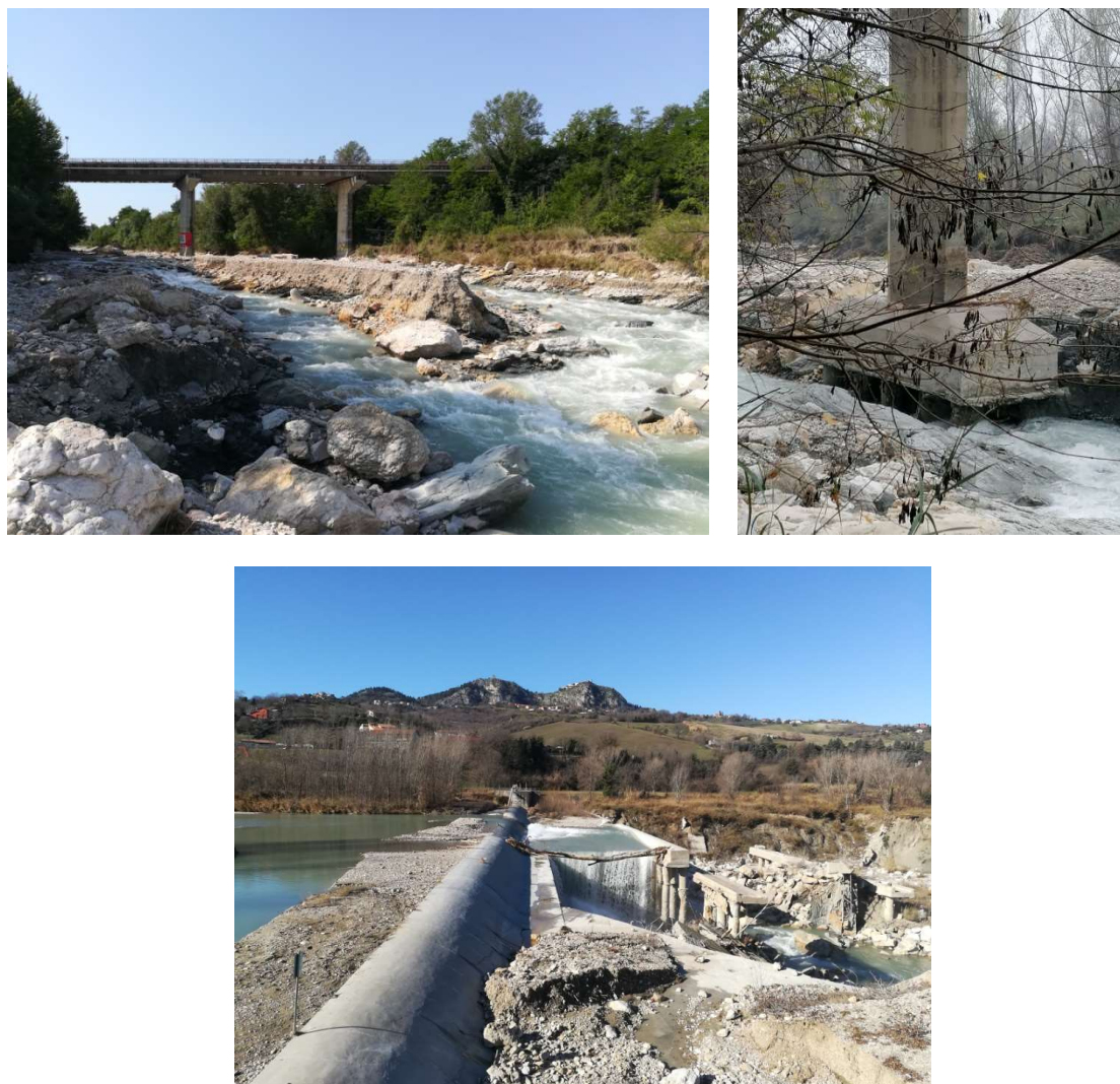
Figure 1.9-1.10-1.11: Dissesto idrogeologico all'altezza di Ponte Verucchio – Anno 2019
