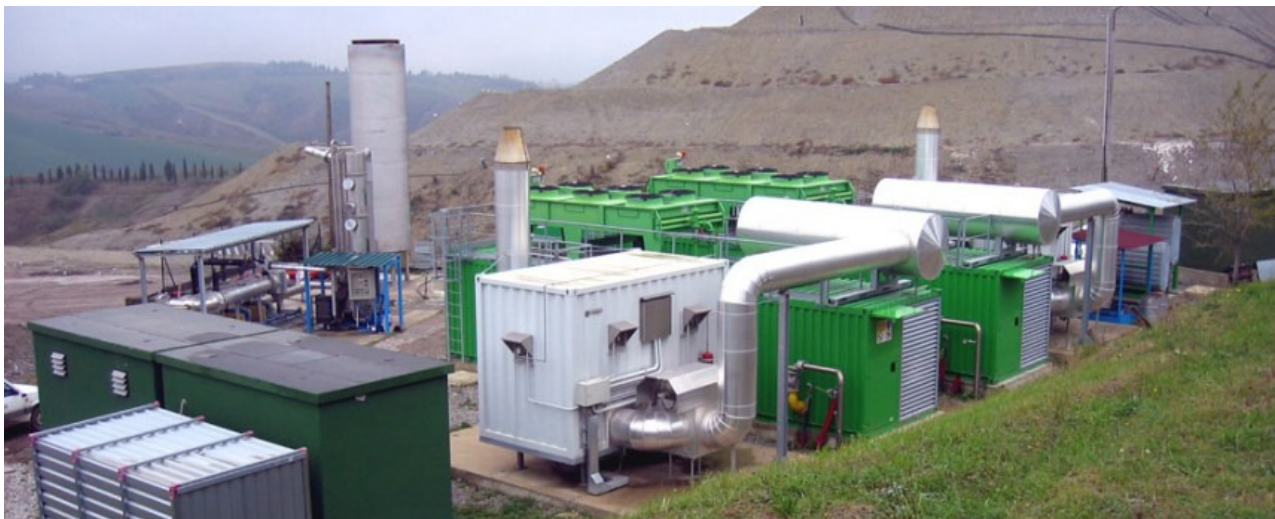
Vista dei motogeneratori e della torcia di emergenza
