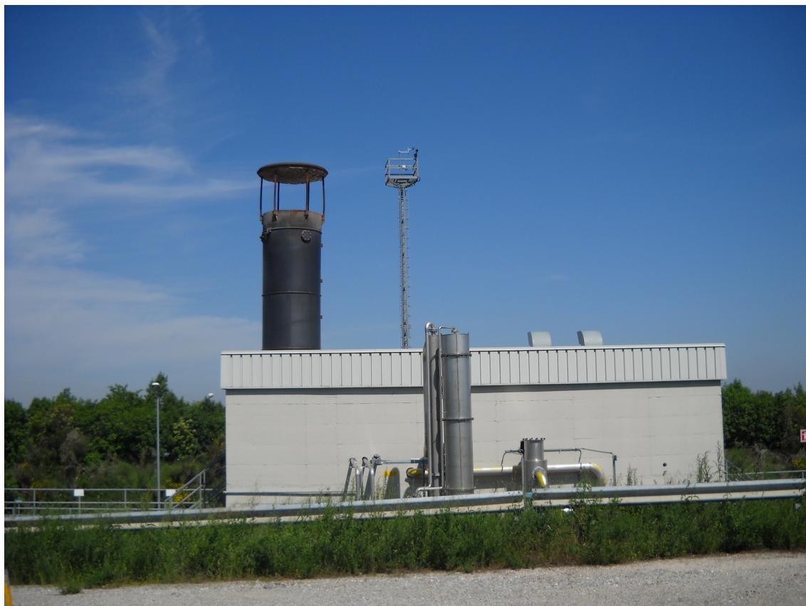
Vista della torcia di emergenza
