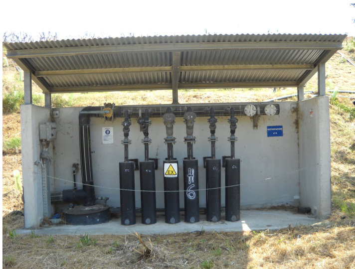
Vista di una sottostazione per la regolazione del biogas di discarica
