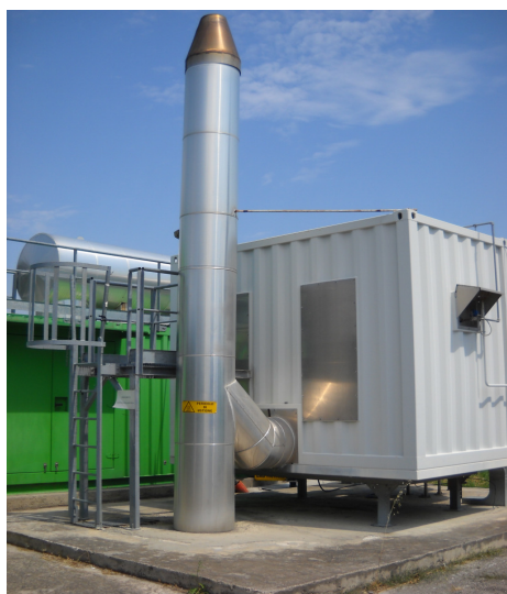
Vista di un motore per la cogenerazione del biogas
