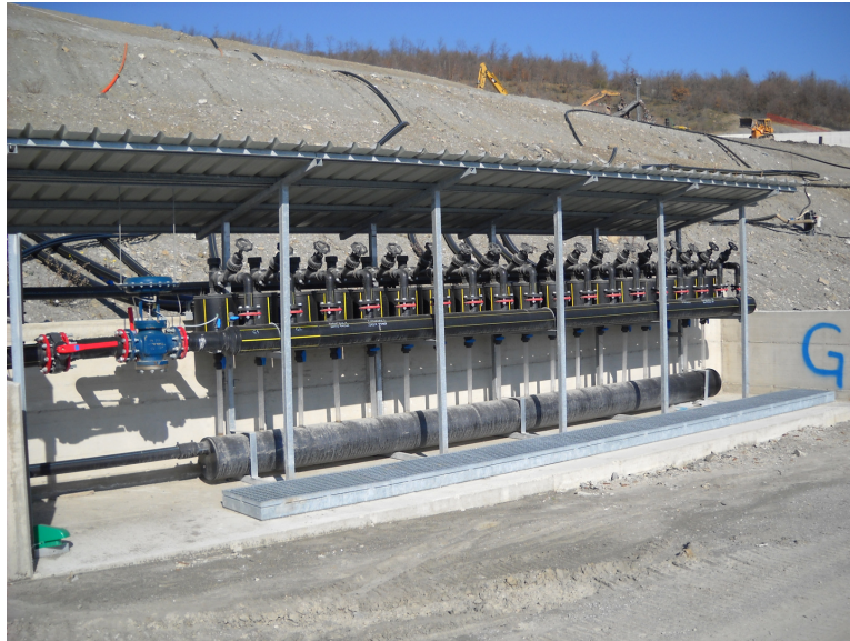
Vista di una sottostazione per l'estrazione del biogas
