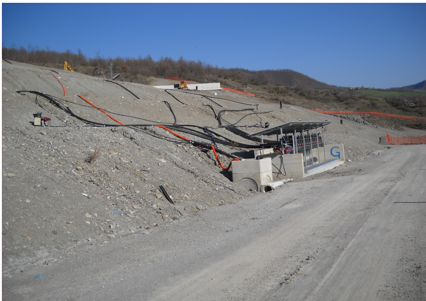
Vista particolare del sistema di raccolta del biogas
