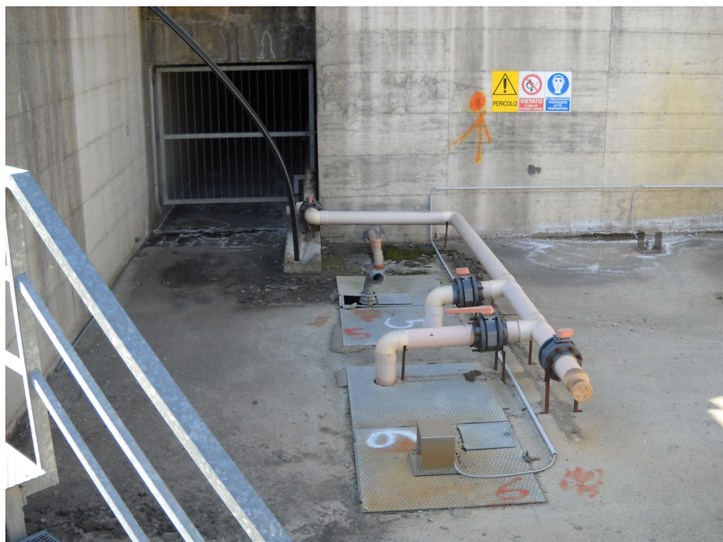
Vista di serbatoio interrato per la raccolta del percolato
