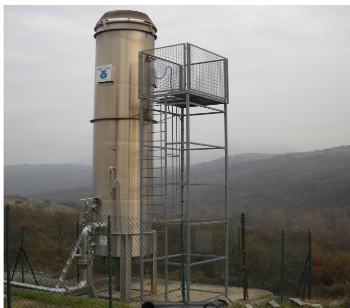
Vista della torcia di emergenza
