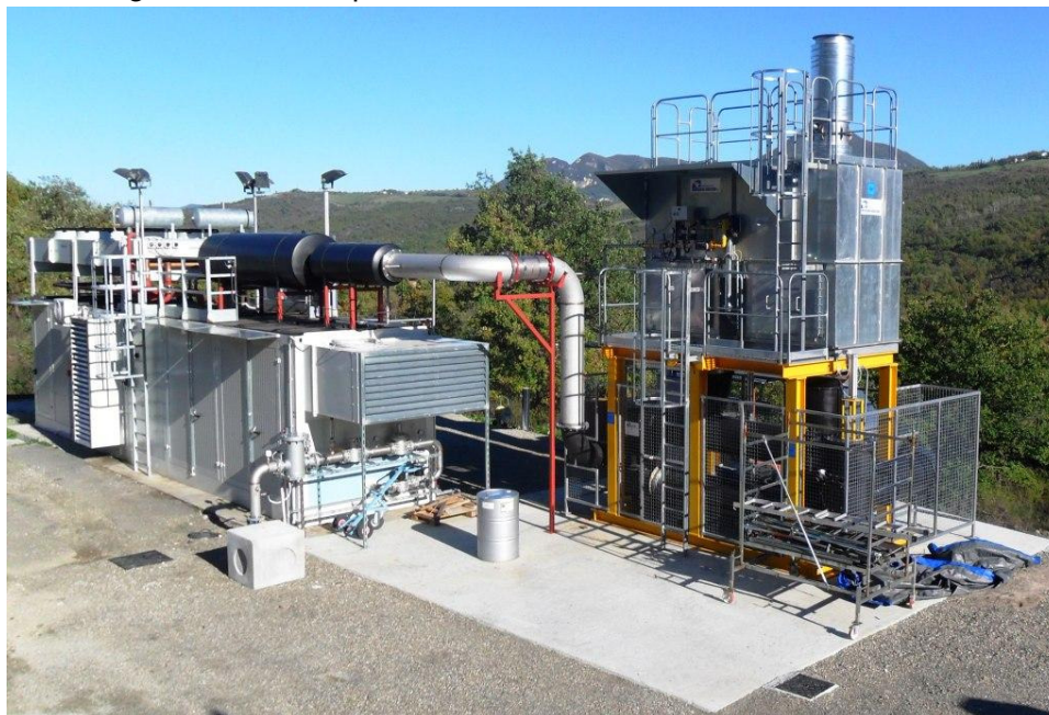
Vista del motogeneratore
