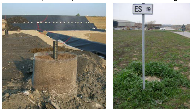
Vista di un camino esalatore
