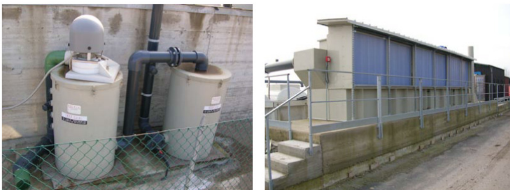
Vista di drum e scrubber
