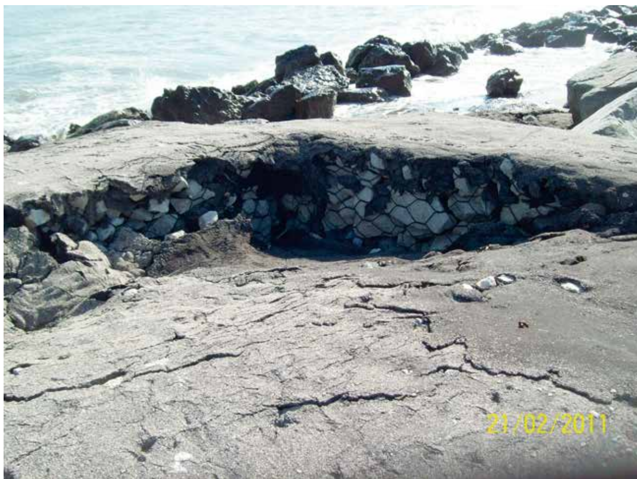
Figura 100 - Poligono Militare di Foce Reno: in evidenza i collassi a cui è soggetta l'opera di difesa radente (21 Febbraio 2011).
